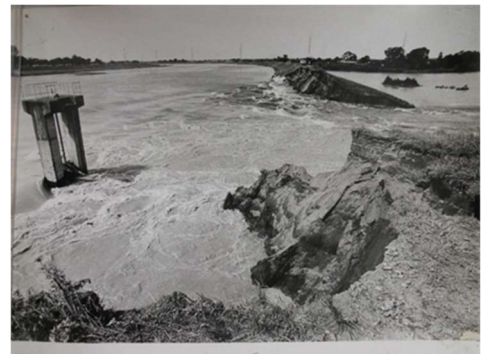
(写真) 1981 年 8 月 24 日の小貝川堤防決壊状況
