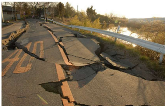
(写真) 東日本大震災被災状況
